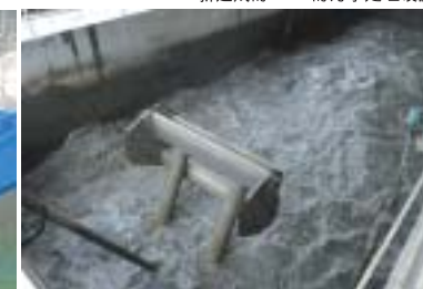
▼新建成的MGC的污水处理设施。
